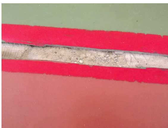
Uszkodzone podłoże pod wykładziną
