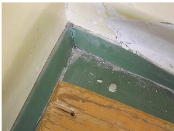
Uszkodzony tynk w poziomie listwy cokołowej oraz powyżej
