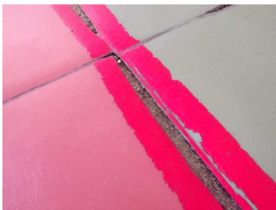
Rozstępy w wykładzinie Sali gimnastycznej z widocznym podłożem
