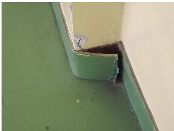
Odspojona listwa cokołowa od podłoża
