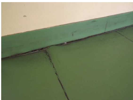
Widok sfalowanej odklejonej od podłoża wykładziny przy listwie cokołowej
