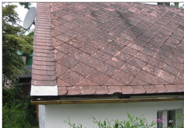
Fot. 2 Płyty azbestowo-cementowe płaskie
