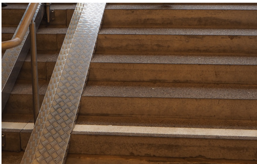
Rysunek 5.7 Przykład prowadnicy wspomagającej przemieszczanie się po schodach z rowerem Źródło: zasoby VIA VISTULA
