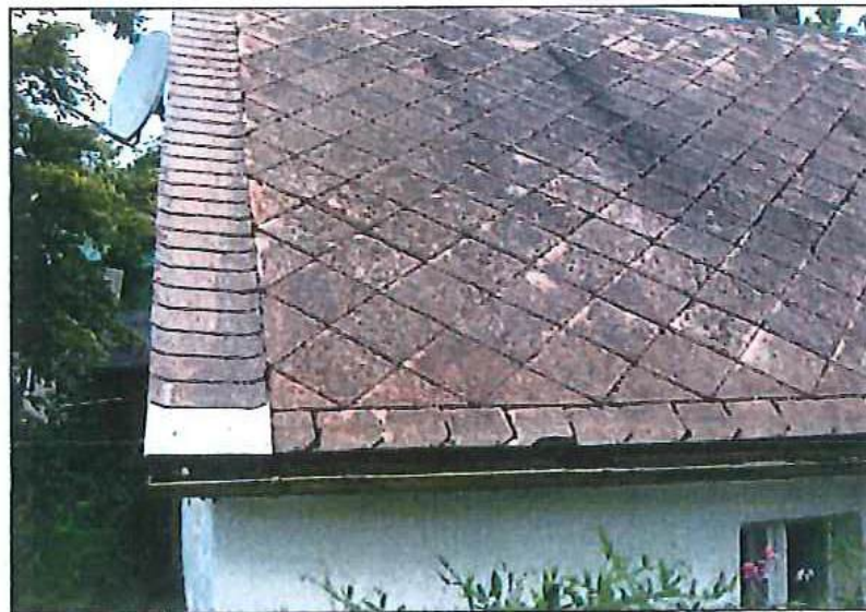
Fot. 2 Płyty azbestowo-cementowe płaskie
